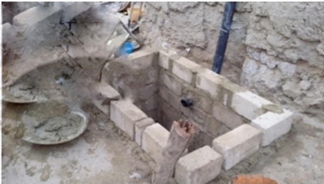
Mausolée Mahamane Askia : Une fosse fixe a été créée pour récupérer les eaux usées et les déchets de la toilette créée à l'étage.
