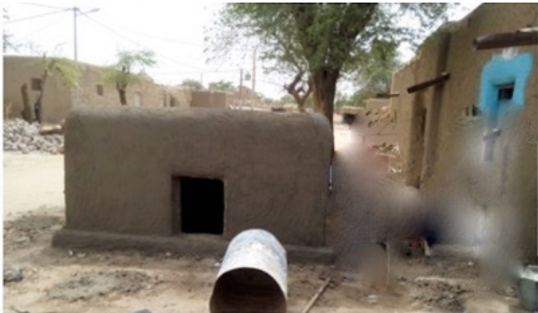
Le mausolée de Cheikh Nouh : la première couche d'enduit extérieur ; la gargouille du bâtiment voisin (en haut à droite) met en danger le mausolée. Elle doit être déplacée.
